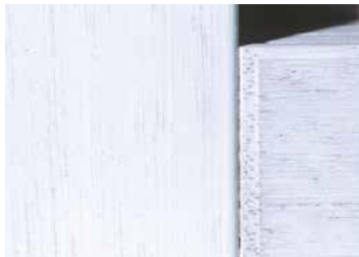
Über eine unbehandelte V-Fuge wird Feuchtigkeit aufgenommen
